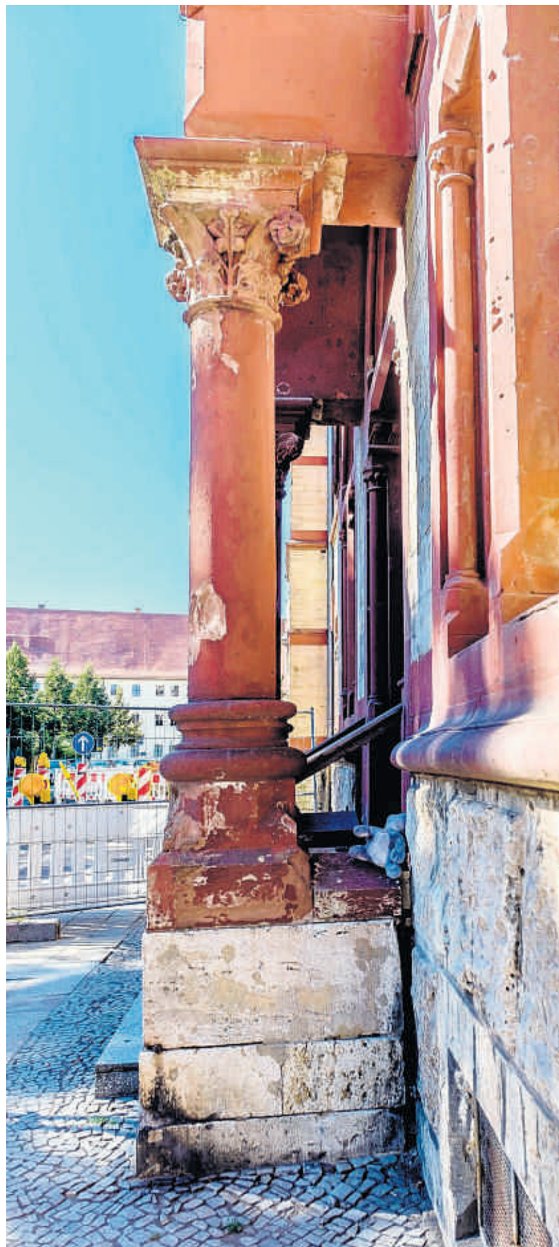
Für jedermann sichtbar sind die Verschiebungen und sonstigen Schäden am Portal der bald 125 Jahre alten Hauptpost in Wittenberg.
